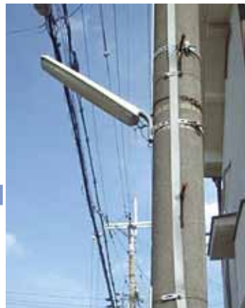
蛍光管防犯灯
