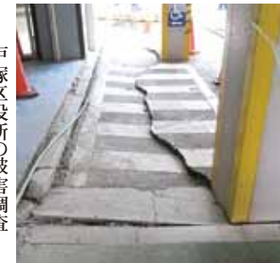
戸塚区役所の被害調査 (H23.3.12)
