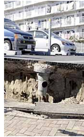
マンションにおける液状化被害調査 (H23.3.12)
